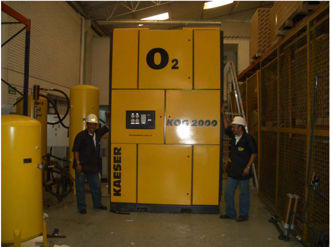
Figura 10.4 – Unidade de adsorção PSA (parte externa)
