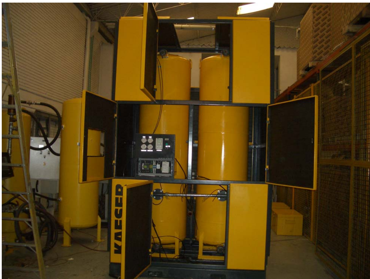
Figura 10.3 – Unidade de adsorção PSA (parte interna)
